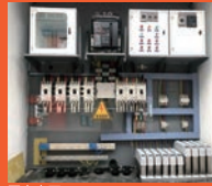
国家电网 箱式变电站
