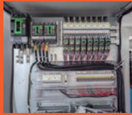
工业自动化控制柜 储能电池
