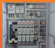
工业自动化控制柜 气体处理
