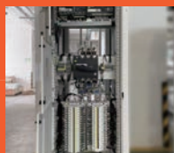
数据中心列头柜
