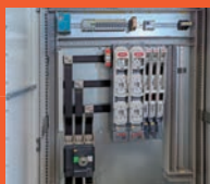
工业自动化控制柜 混凝土搅拌站
