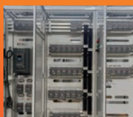
工业自动化控制柜 石油化工
