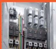
工业自动化控制柜 光伏组件
