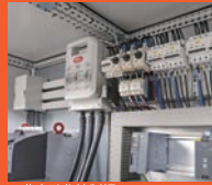
工业自动化控制柜 港口机械
